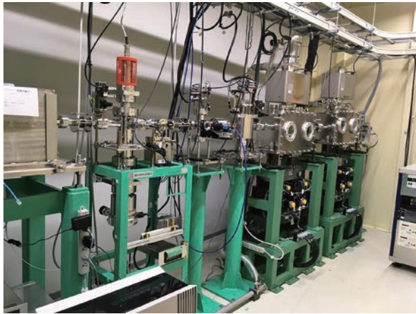
図5 排気システムがイオンポンプ化されたBL19LXUの光学ハッチ内の様子
